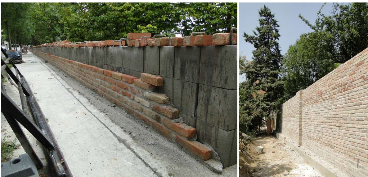
85. A Ménesi úti támfal megerősítő rekonstrukciója 2011-ben: téglaburkolat visszahelyezése (Fotó: Honfi Péter, 2011)
